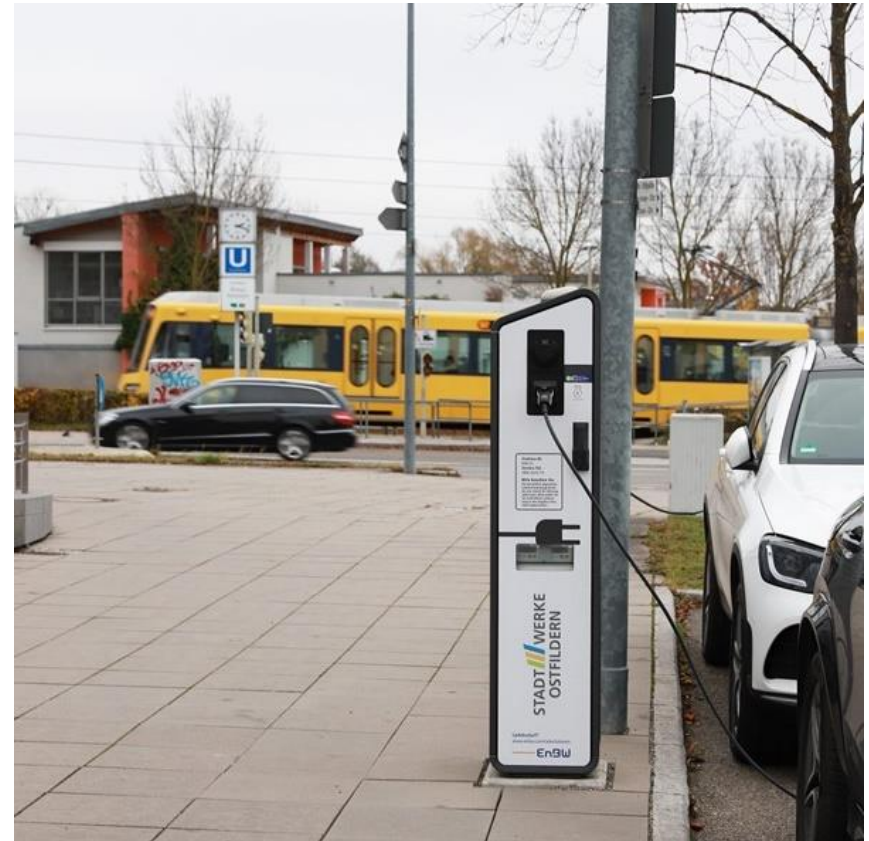
E-Ladestation, Scharnhäuser Park (Quelle: Stadt Ostfildern)
